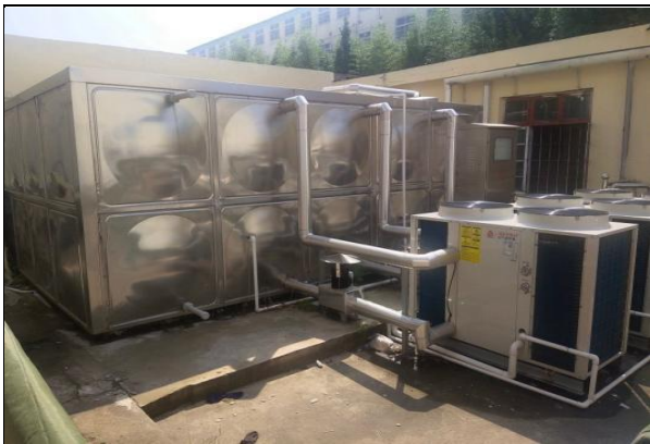
宿舍空气能热水设备
